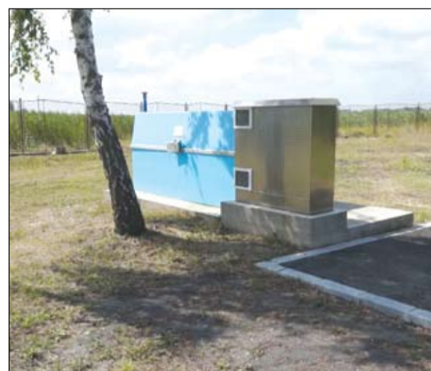
Új kút, megújított berendezések biztosítják Izsák ivóvíz ellátását
